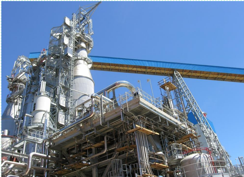
CELCO Arauco – Fábrica de Nueva Aldea - Chile
