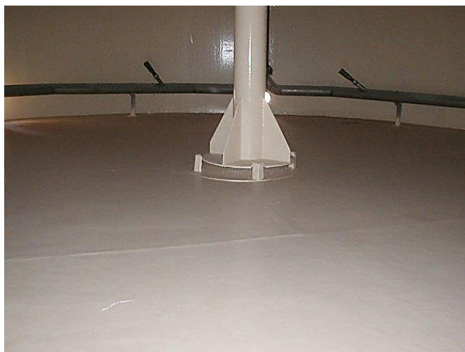
Interior de reator anaeróbico Fonte: Cambará S.A.
