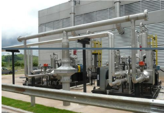
Estação de purificação de biogás Fonte: Jordão, 2014
