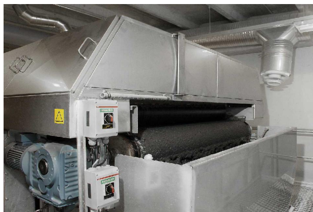
Desaguamento de lodo
