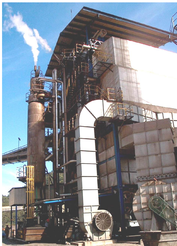
Caldeira de biomassa queimando uma diversidade de biocombustíveis
