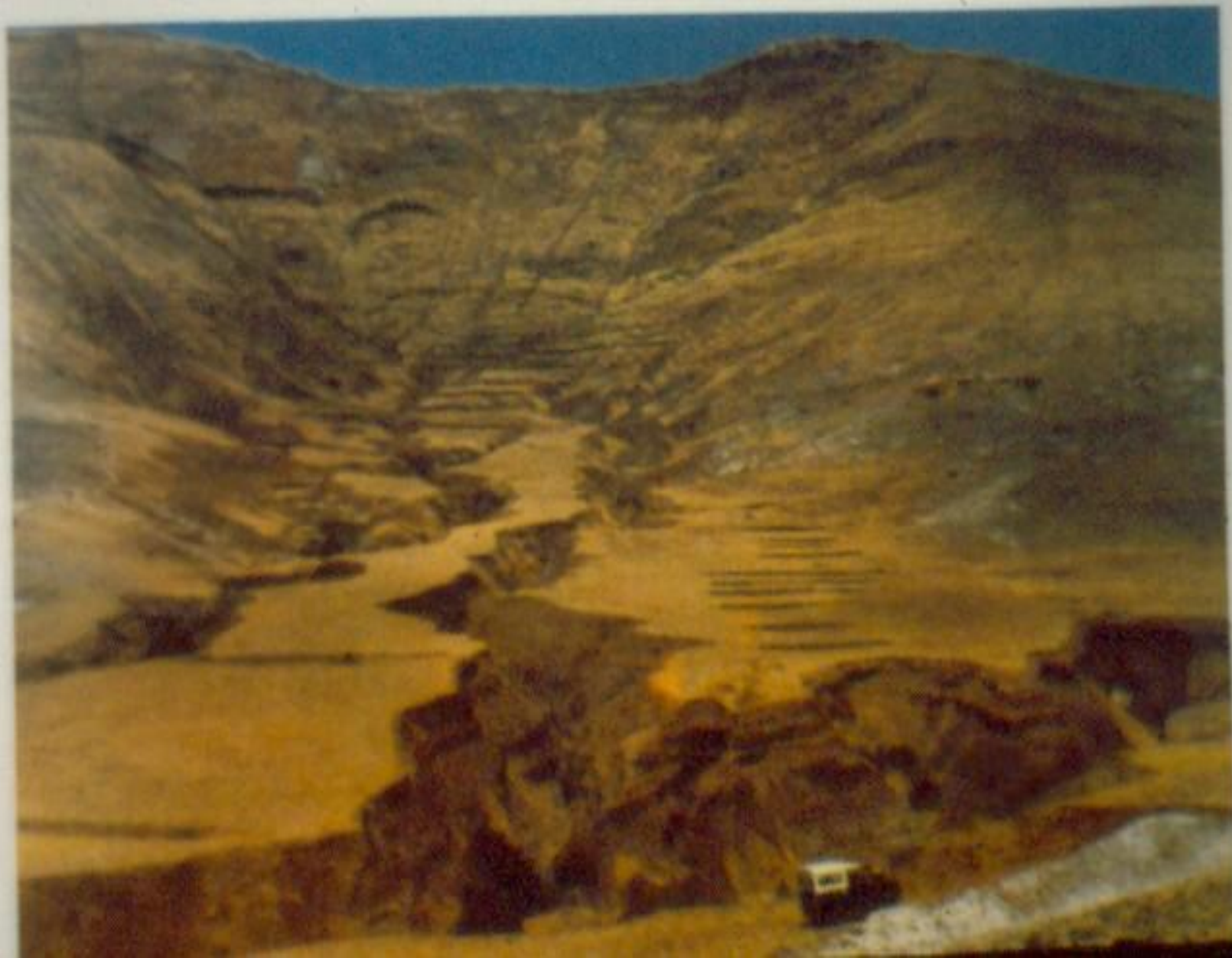
Fot. 17 — Aspecto característico de erosão superficial que foi arrastando para o sopé do cabeço a terra arável das elevações, sendo depois esses depósitos coluviais rasgados pelas águas escorrentes que a encosta já não sustém — Ribeiro da Volta do Serrado — Ilha de Porto Santo, Junho/975.
