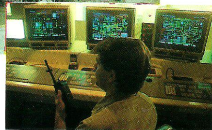
Sistema Digital de Controle Distribuído
