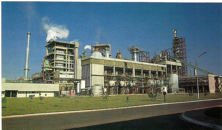
Vista da caldeira de recuperação
