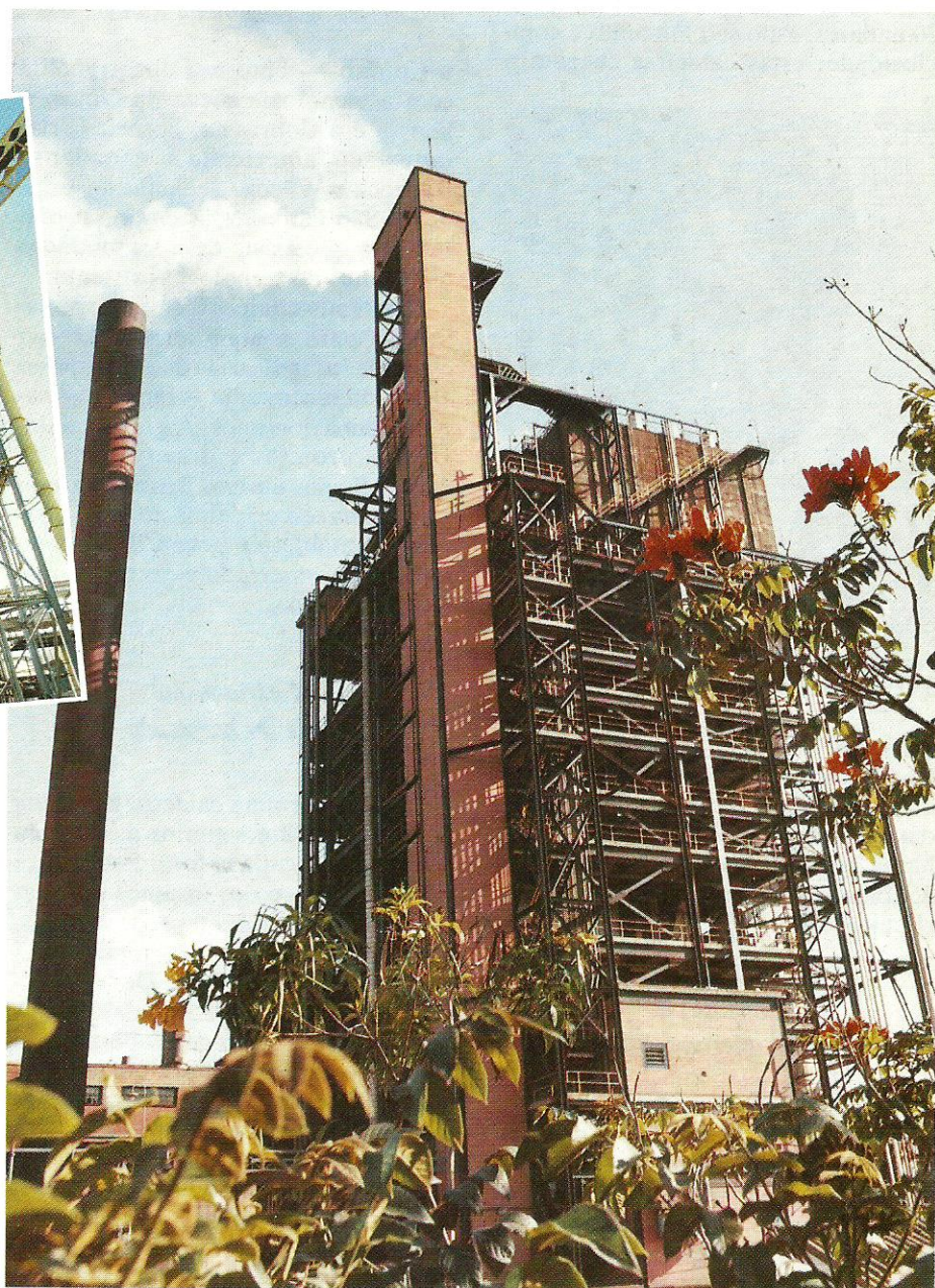
Na Champion está instalada esta caldeira de recuperação da Cobrama
