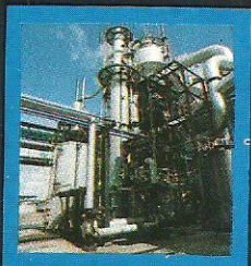
Coluna Depuradora (STRIPPER).
