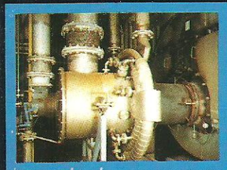
Incinerador de Gases.
