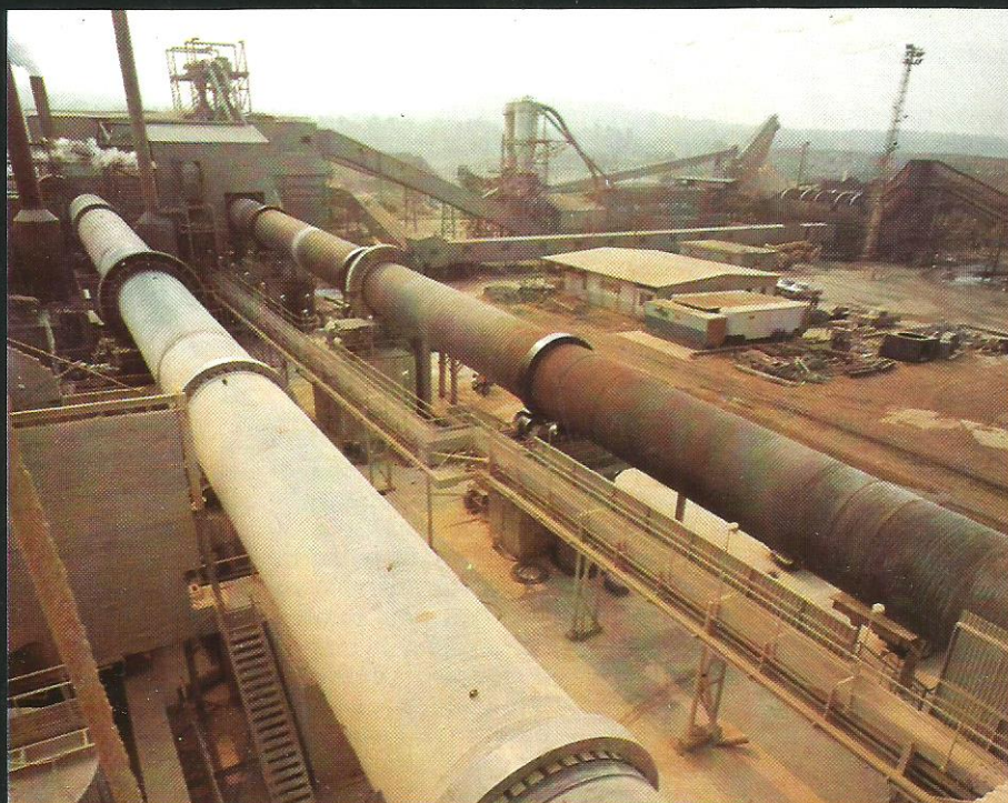
Forno Boliden Allis instalado nos Estados Unidos
