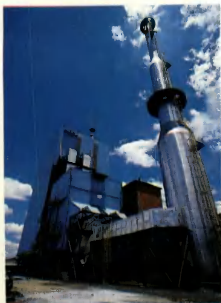
Moderna caldeira instalada durante o plano de expansão da empresa.
