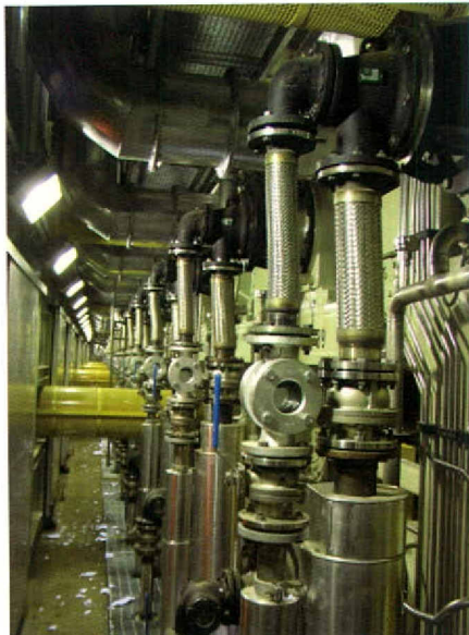
Instalação de uniões rotativas da Kadant Johnson
