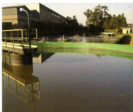
Estação de tratamento de efluentes, unidade Jacareí, VCP
