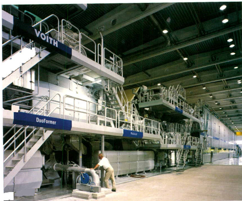
Máquina de papel com caixas estabilizadoras modelo ProRelease Plus, instaladas na secagem
